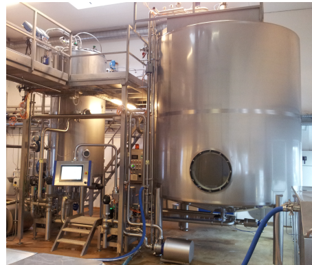
Figure 1: En tank i processmiljö
